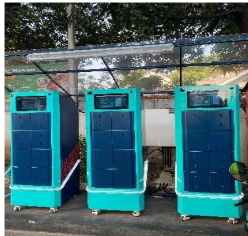
Gambar 2. Stasiun Penukaran Baterai Kendaraan Listrik Umum Sumber : Diolah penulis (2024)
